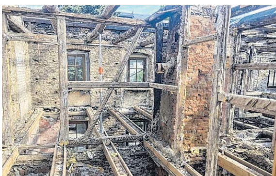
Damit die Arbeiten im Haus der Roschers weitergehen, muss jetzt ein neues Dach drauf. FOTO: KUNTZE
